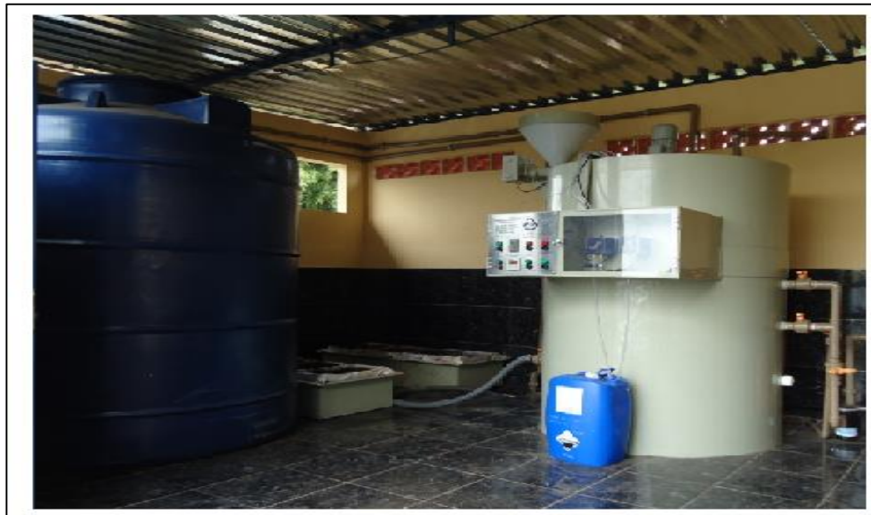
Figura 20 - Transferência da água para o tanque reator de tratamento.
