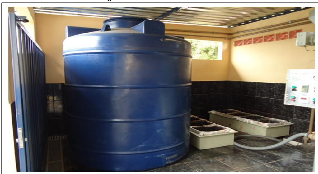
Figura 19 - Caixa de efluente bruto.
